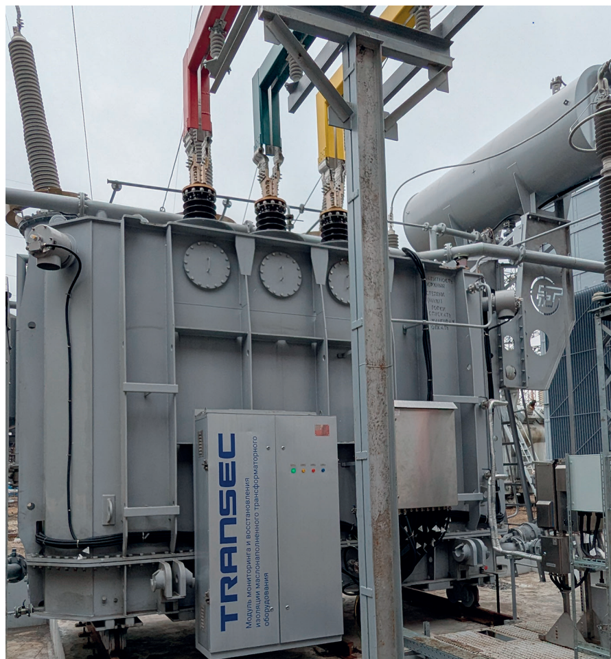
Рис. 1. Первый в России высокоавтоматизированный силовой трансформатор ТДЦ-160000/220-УХЛ1 с предустановленной АСВИ типа TRANSEC
